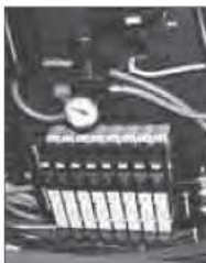
Isla de válvulas V20 instalada en el armario de control.
